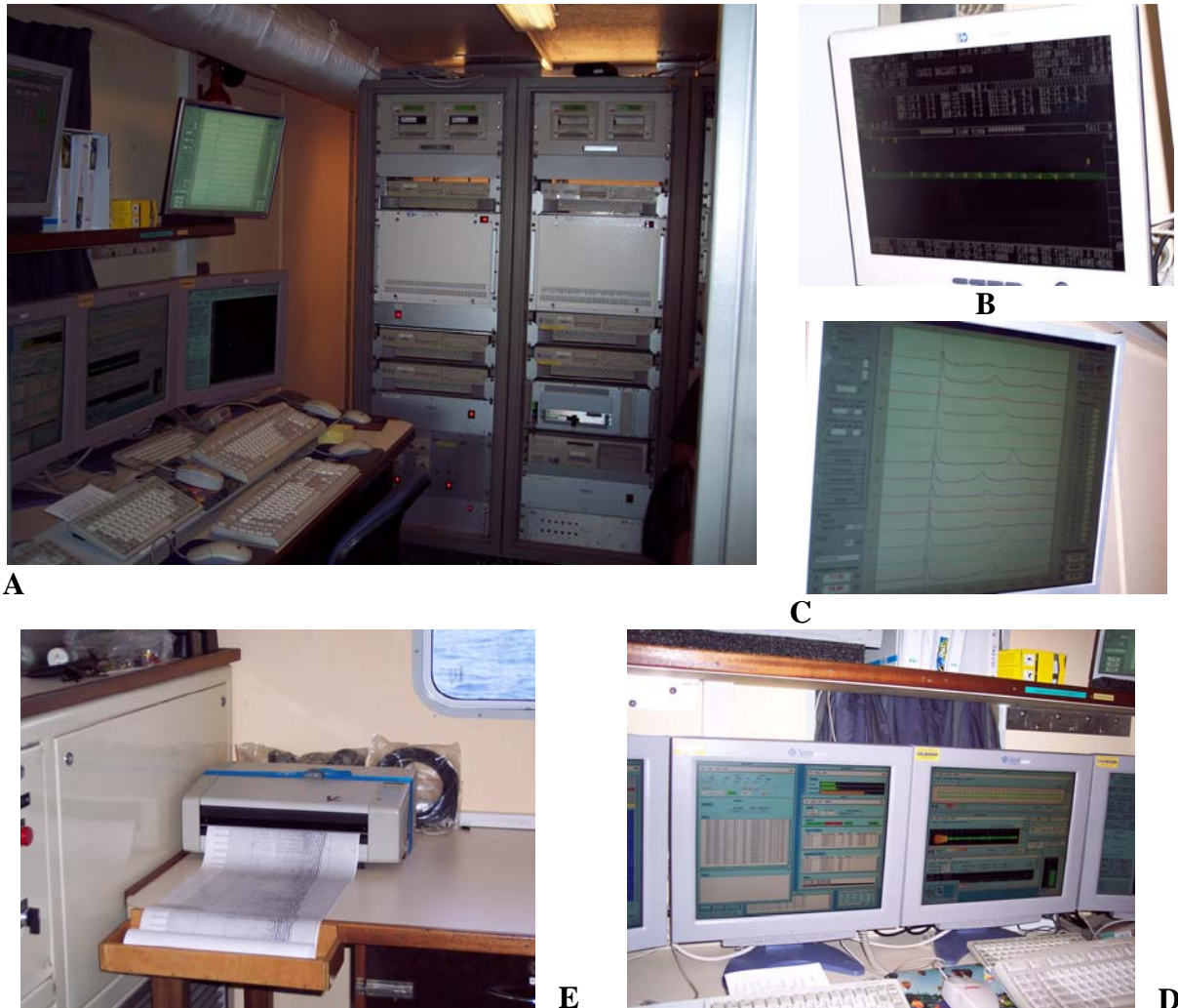
Figura 37: Sistema de adquisición situado en un contenedor autoportante en la borda babor y conectado con el laboratorio científico principal. A. Vista general con el corazón del sistema y el dispositivo de grabación. B, C y D. Detalles de los monitores de control de posición y estado de birds; estado y sincronización de cañones con ACTRIS y calidad de señal y snack automático, respectivamente. E. EPC para la impresión monotraza en tiempo real.
