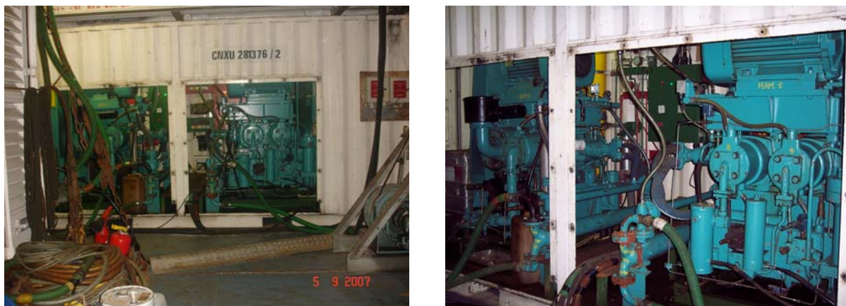
Figura 34: Compresores HARMWORTHY en dos contenedores móviles. Vista general (izquierda) y detalle (derecha)
